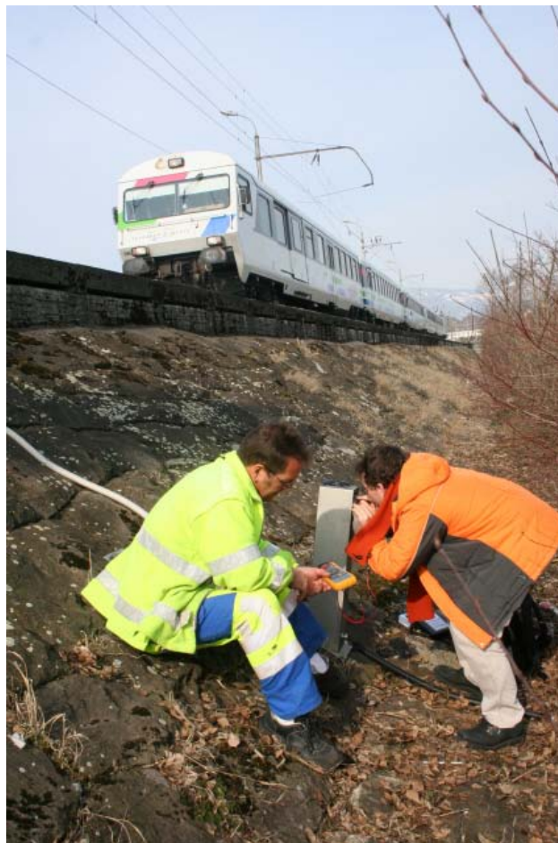
Martin Dorigo von HSR und cnlab bei der Montage einer Zeitschaltuhr für täglichen Neustart beim Trafokasten Seedamm am 18. März. Bild: Kurt Anderegg
